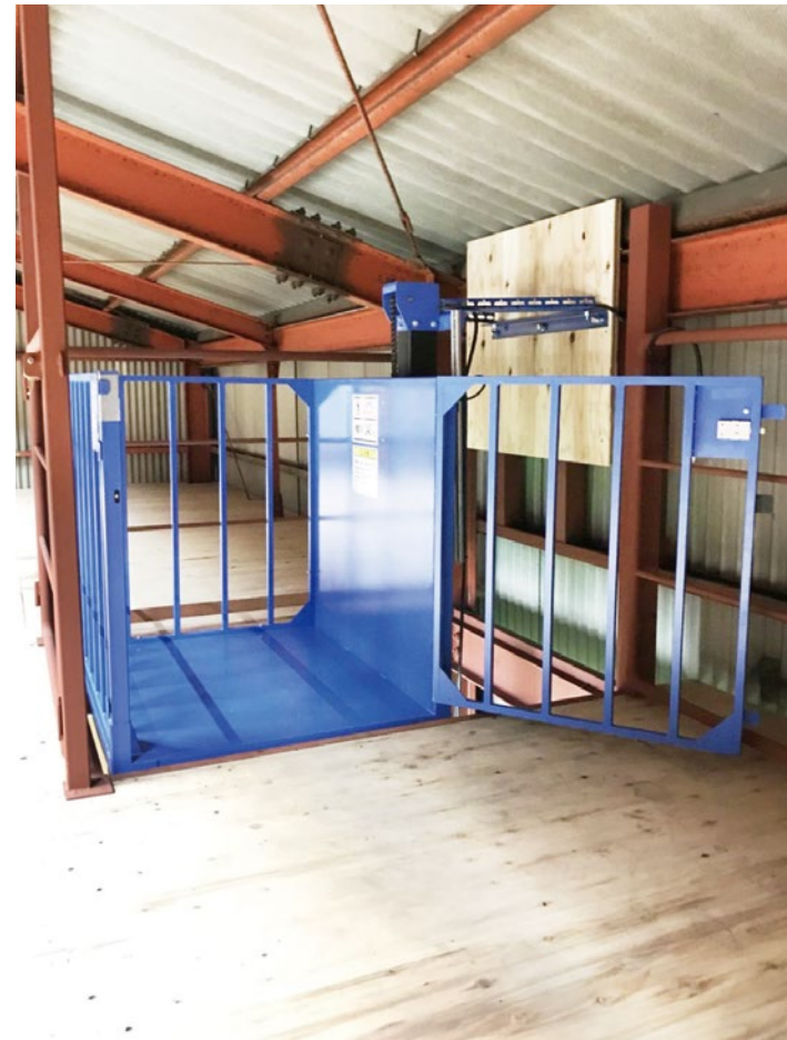
1階～2階・倉庫に設置
