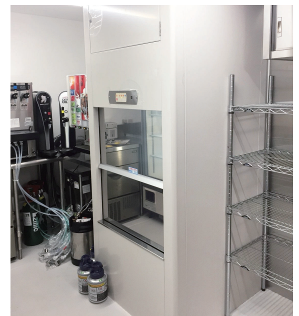
小荷物昇降機(ダムウェーター)の設置事例
