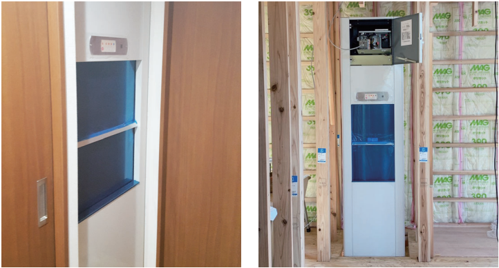
小荷物専用昇降機（ダムウェーター）の設置事例
