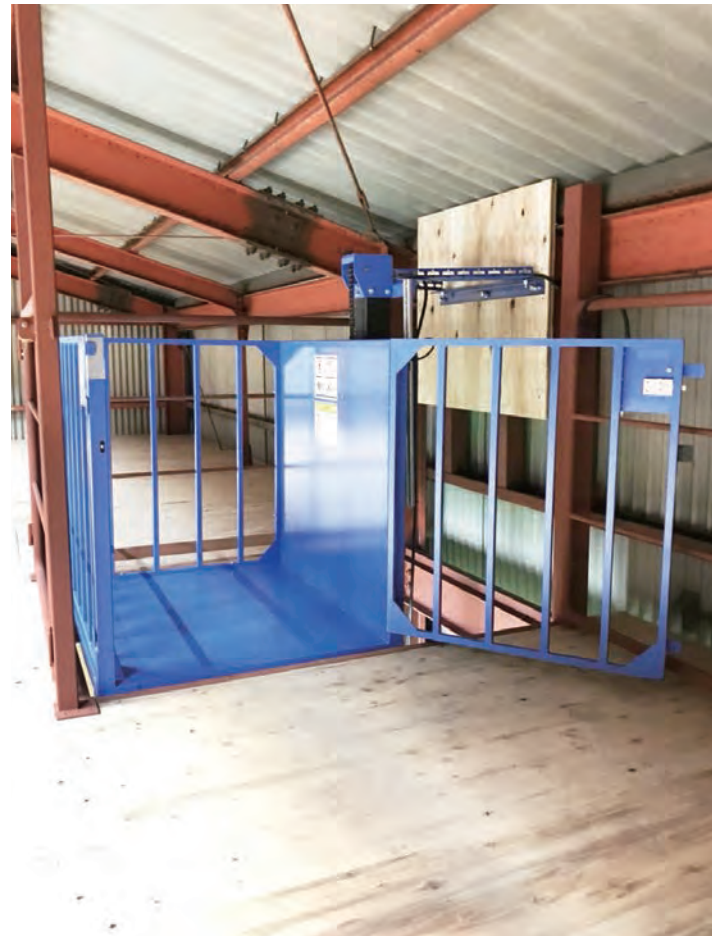
1階～2階・倉庫に設置
