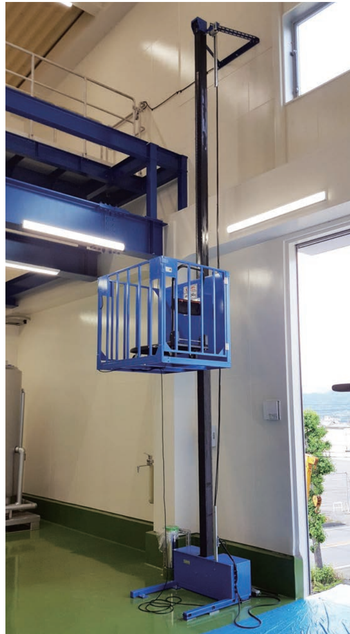
1階～2階・工場に設置
