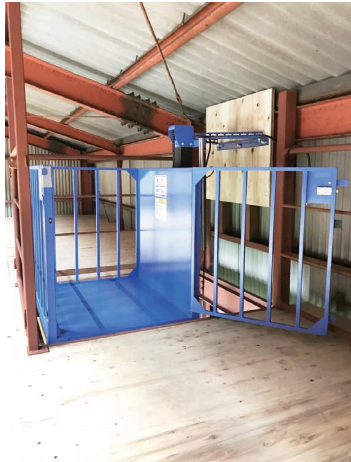
1階～2階・倉庫に設置
